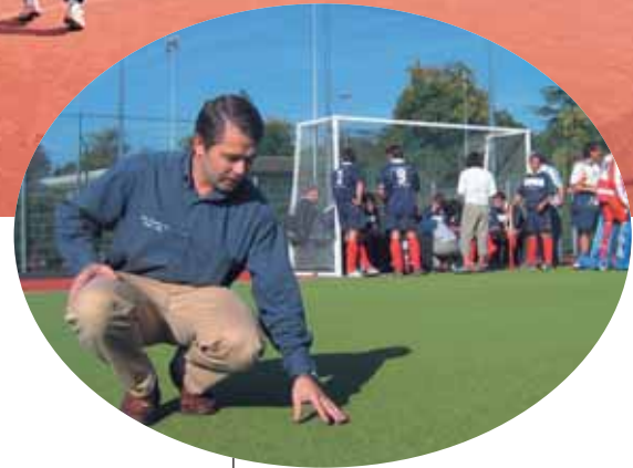
AU STADE GEORGES-LEFÈVRE Réfection complète d'un terrain avec un nouveau revêtement synthétique.
